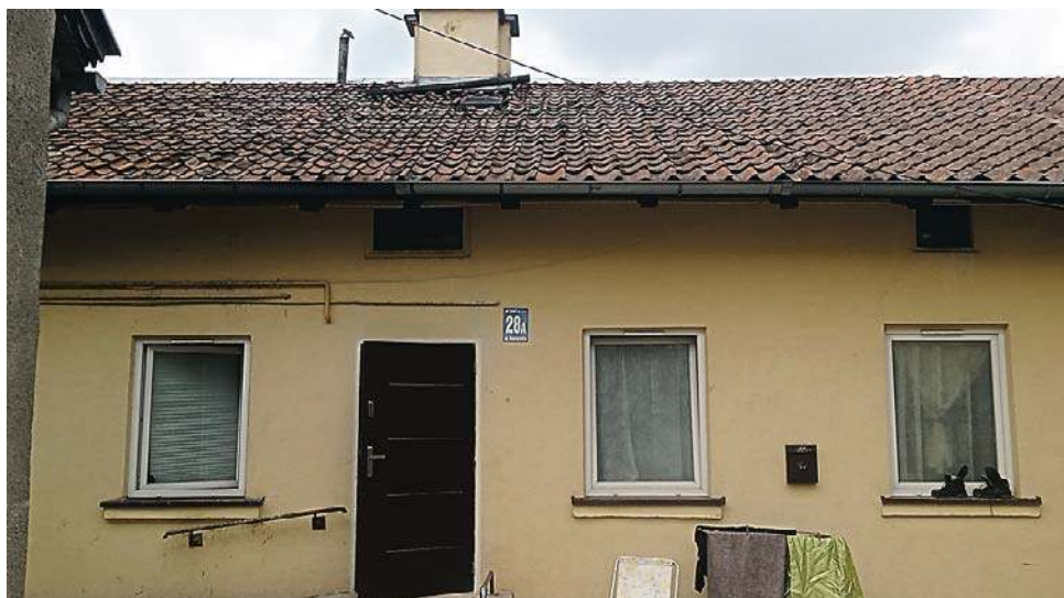
Dach przecieka w wielu miejscach
