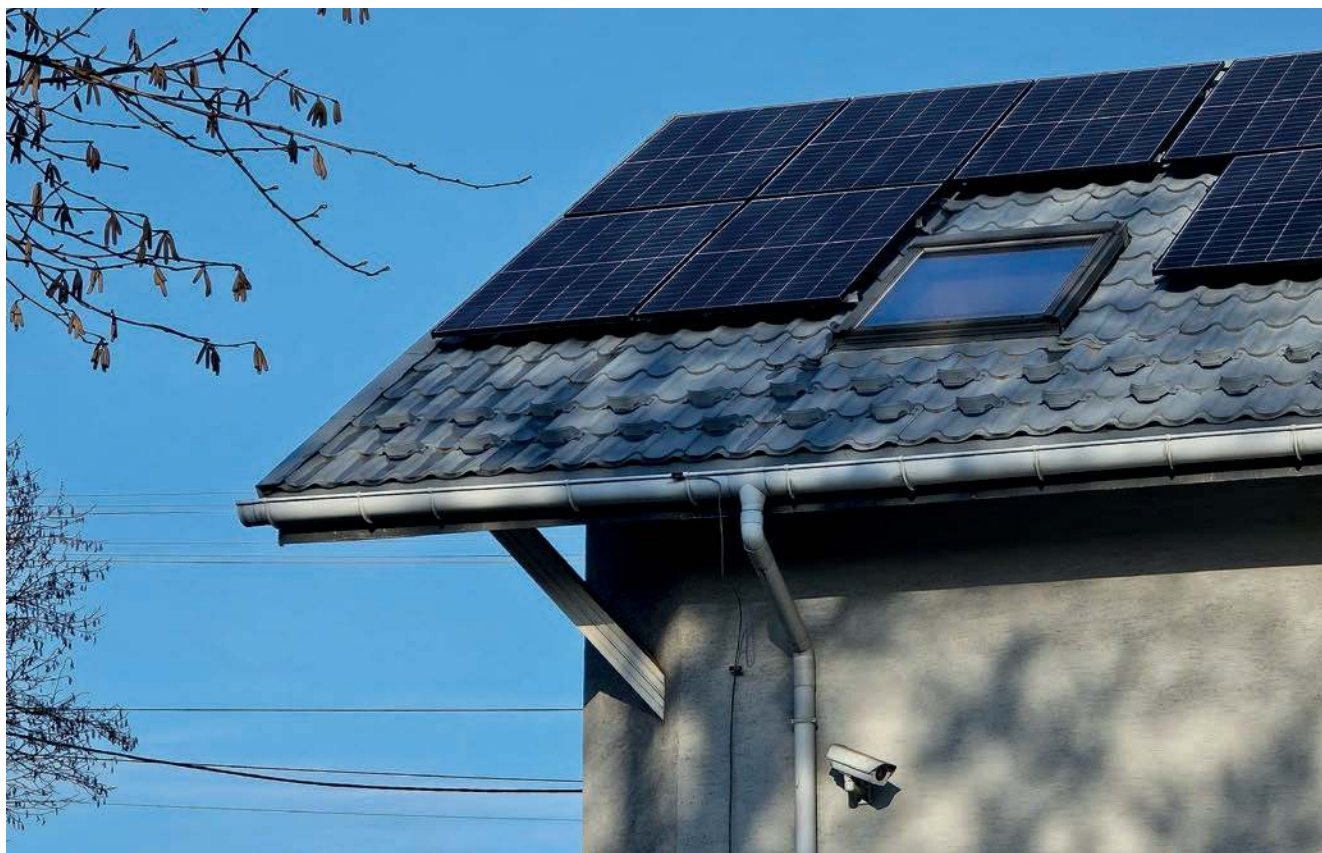
Panele fotowoltaiczne to jedno z najczęściej wybieranych urządzeń do produkcji zielonej energii
