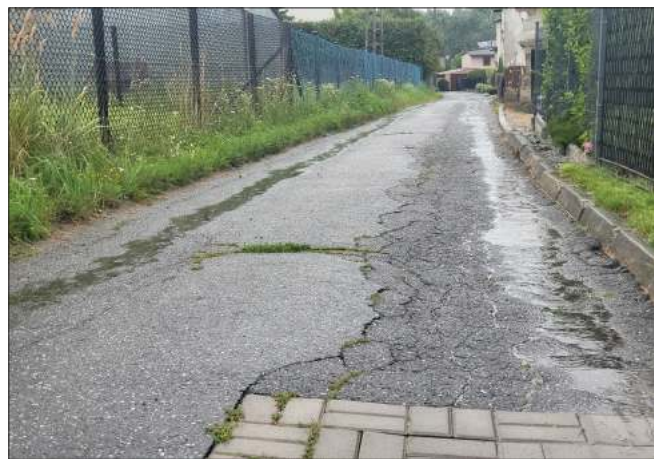
Droga wymaga niezwłocznego remontu
