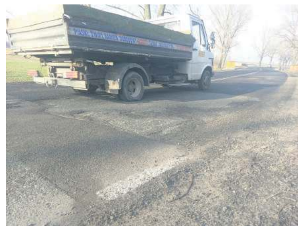
Po remoncie odcinka drogi pozostał niebezpieczny uskok
