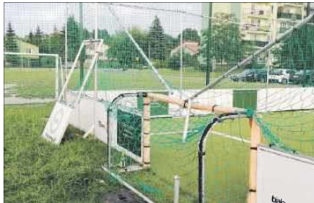
Od wielu miesięcy radny interweniuje w sprawie uszkodzeń infrastruktury boiska na kompleksie rekreacyjnym „Aktywna Biała”. Miasto decyduje się na monitoring tego miejsca
