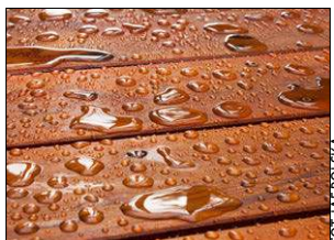
Drewno niezabezpieczone i wystawione na bezpośredni wpływ warunków atmosferycznych z czasem degraduje
