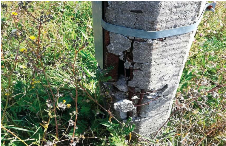
Uszkodzone latarnie mają zostać wymienione jeszcze w tym tygodniu
