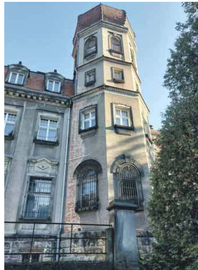
Pałac wymaga remontu
