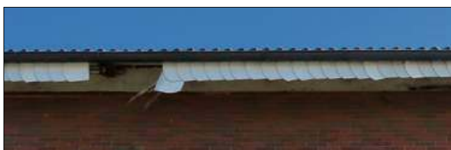
Elementy konstrukcji spadają na ziemię.
