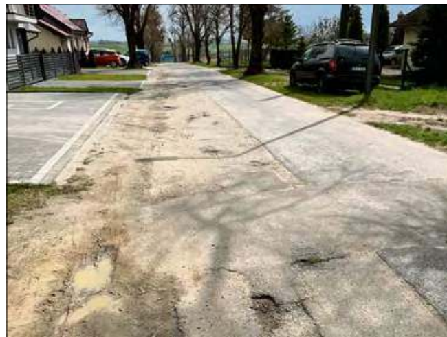
Mimo iż wokół powstaje masa nowych domów, droga pozostaje w katastrofalnym stanie.
