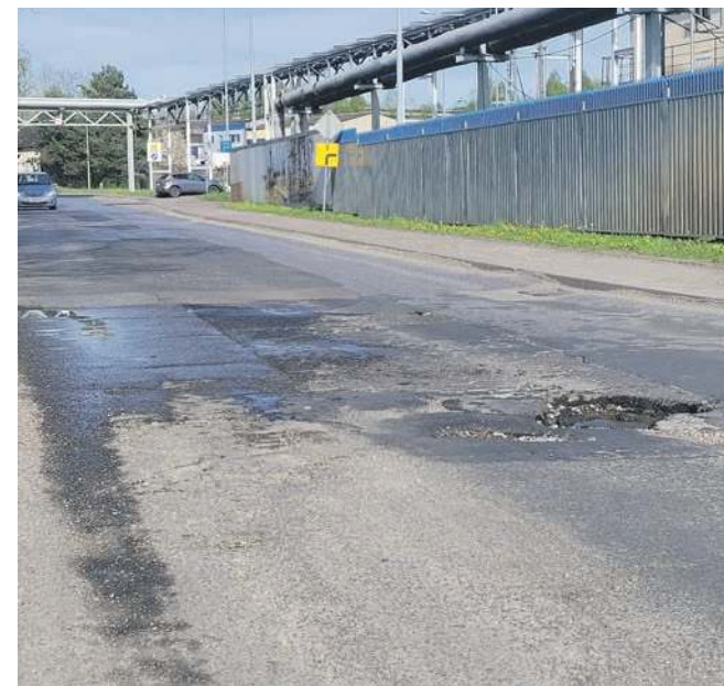
Dziurawy odcinek gminnej drogi w okolicach trzebińskiej rafinerii
