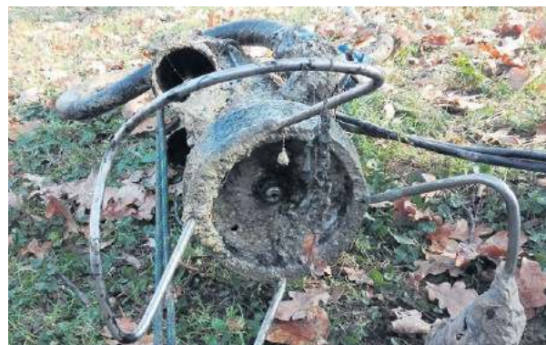
Tak wygląda pompa po awarii. Foto: UG Kondratowice
