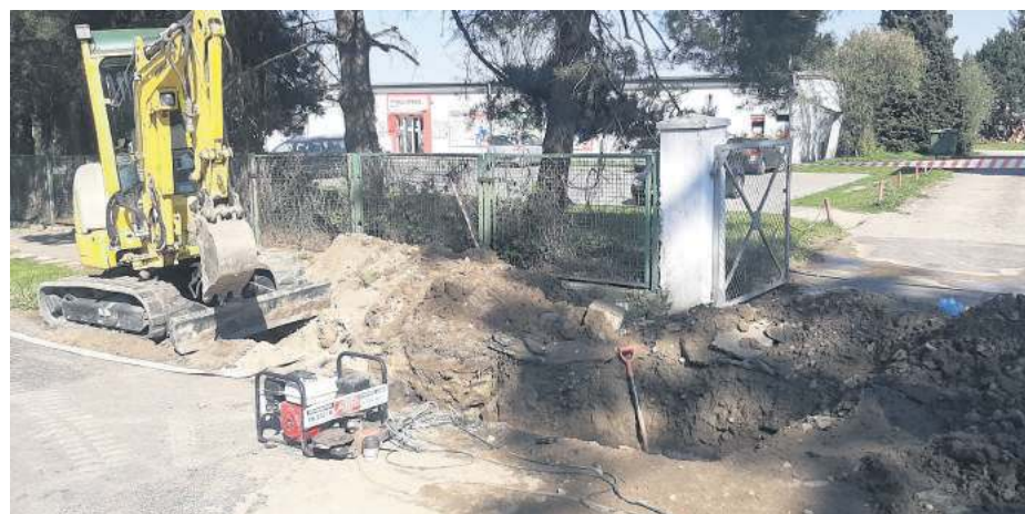
W ubiegłym tygodniu w gminie Przeworno pękły rury wodociągu w siedmiu miejscach sieci wodociągowej, m.in. w dwóch w Jegłowej i w jednym w Przewornie. Na zdjęciu widać prace przy usuwaniu awarii na ul. Kolejkowej w Przewornie
