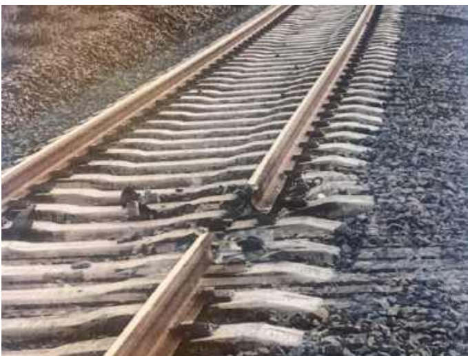
Uszkodzone tory kolejowe przez agentów GRU.
