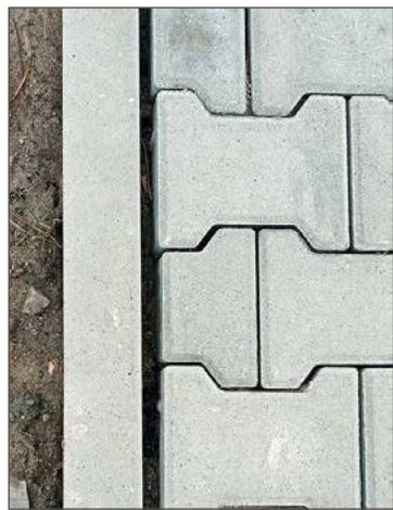
Tak wyglądają przerwy między kostką a krawężnikiem.
