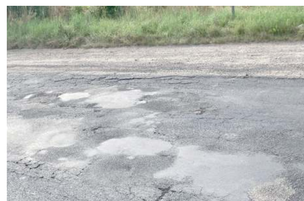
Droga w Nowej Jedlance jest pełna dziur, nie ma chodnika. Starostwo tak się chwali remontami dróg
