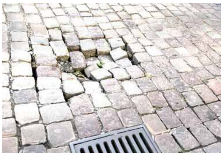
Przyczyną dziury, która powstała na jezdni przy ul. Kuśnierzy była nieuszczelnność rury
