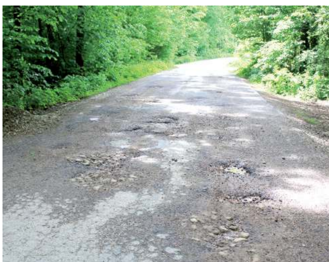
Droga, która prowadzi do części Kolonii Góra Puławska należy do nadleśnictwa i jest w bardzo złym stanie. Mieszkańcy muszą poświęcić trochę czasu, aby pokonać odcinek manewrując autem w celu ominięcia dziur
