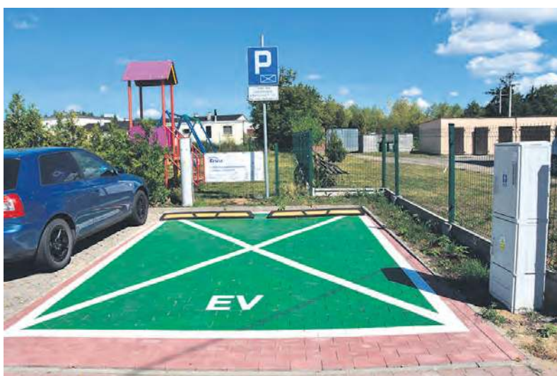
Stacja ładowania pojazdów elektrycznych przy ulicy Słonecznej.
