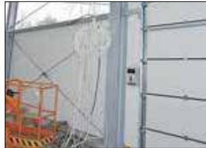
Przewody elektryczne złodzieje skradli z terenu budowanej hali magazynowej.
