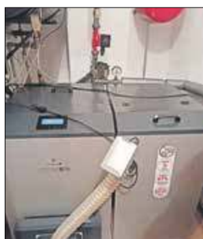
W wyniku realizacji kilku projektów OZE zainstalowano na potrzeby mieszkańców kolektory słoneczne, pompy ciepła oraz kotły na pellet
