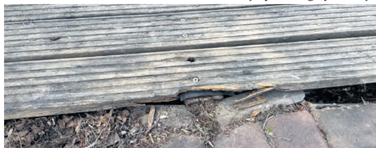
Przegląd pomostów został już przeprowadzony. Wójt gminy zapowiada wymianę spróchniałych lub uszkodzonych desek.
