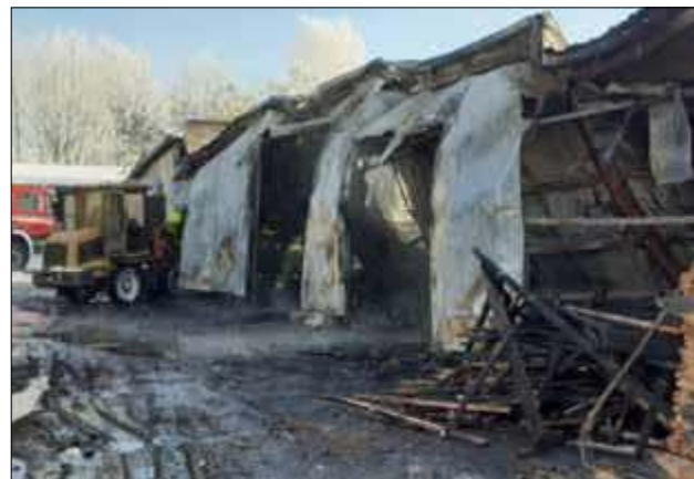
Hala o powierzchni 10 na 20 m została całkowicie zniszczona
