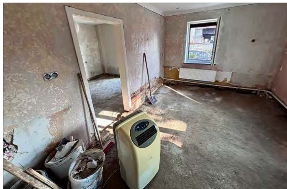
Mieszkańcy osuszają zalane pomieszczenia.
