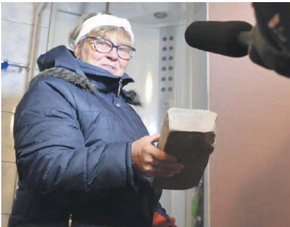
- Ta cegła spadła z dziury w suficie, gdy wchodziłam do łazienki - mówi pani Ula
