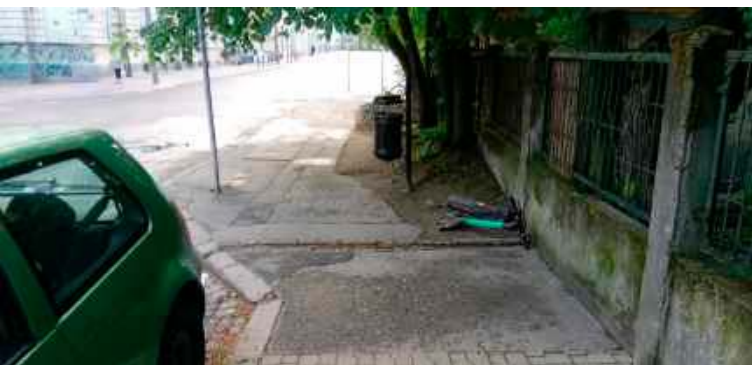
By całość wyglądała jak należy potrzeba wyremontować ok. 25 metrów chodnika. I choć koszt takiego przedsięwzięcia wydaje się być niewielki, miasto na razie nie planuje jego realizacji
