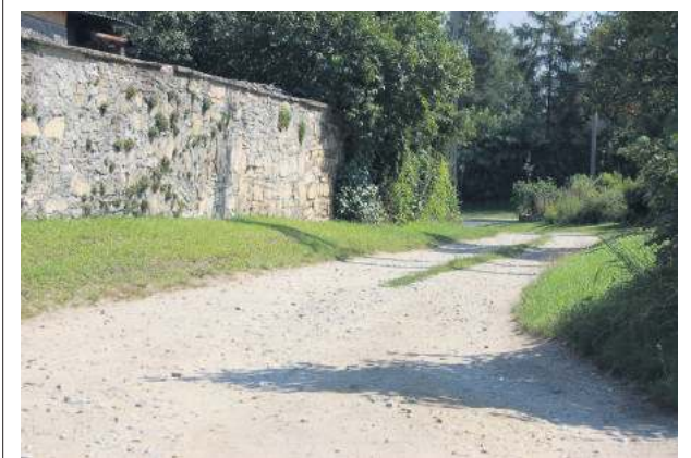
Nawierzchnia na ul. Ludowej w Jegłowej nie jest w najlepszym stanie
