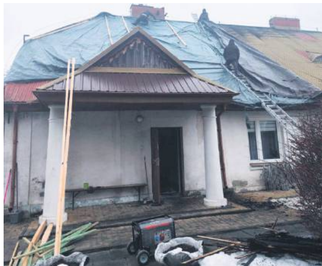
Najpilniejszą potrzebą jest teraz położenie nowego dachu na budynek.
