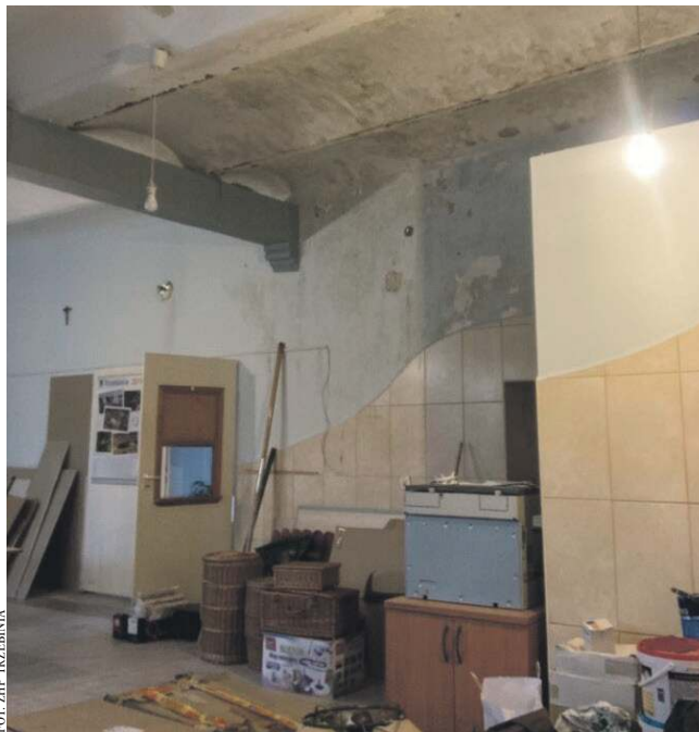
Zalane i zagrzybione wnętrze sali na parterze hufca
