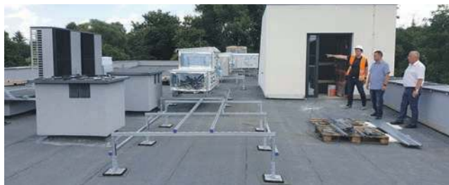
Na dachu budynku znajdują się pompy ciepła i inne ekologiczne urządzenia
