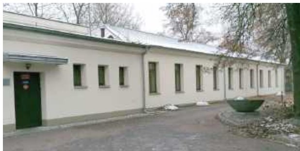
Budynek, choć na zewnątrz wygląda całkiem przyzwoicie, to w środku wymaga wykonania jeszcze wielu prac remontowych
