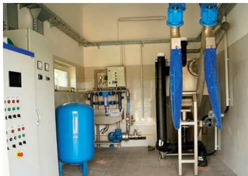
„Serce” zmodernizowanej oczyszczalni
