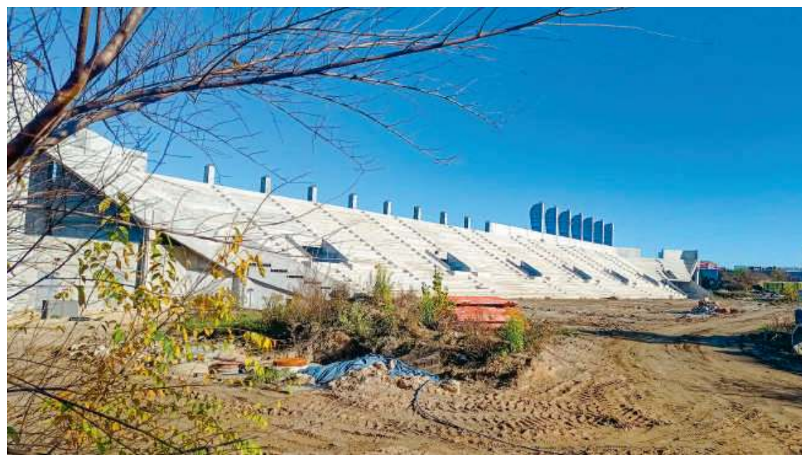
Pierwszy wykonawca RCS zszedł z placu budowy i sprawa trafiła do prokuratury. Od momentu przejęcia inwestycji przez firmę Betonox miną niedługo trzy lata | fot. Facebook/d
