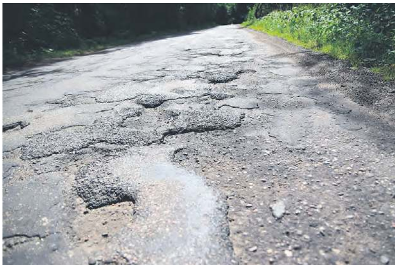
W takim stanie jest odcinek między Wierzchucinem a Błądzimem.
