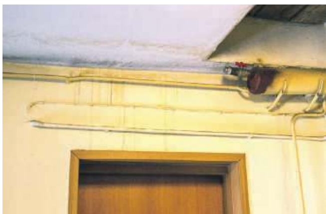
Klatki schodowe i mieszkania notorycznie są zalewane
