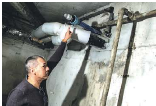
Nowe przyłącze wody od 4 lat czeka na podłączenie
