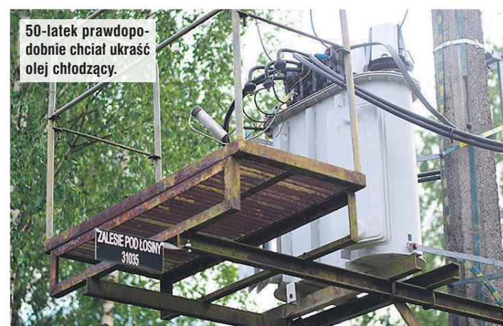
Dlaczego nawet dotknięcie transformatora wiąże się z ryzykiem? O tym opowiedział nam Waldemar Olter z Enei.
