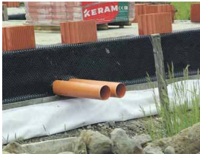
Nowe osiedla powstają, ale gdzie będą odprowadzane nieczystości?
