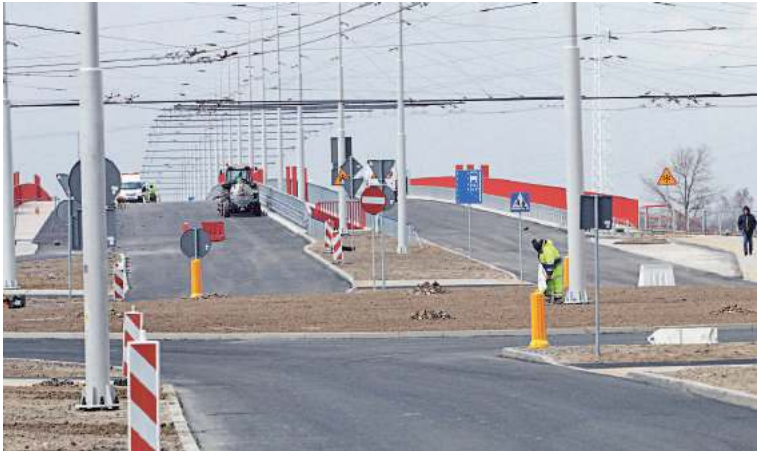
Przedłużająca się procedura dopuszczenia wiaduktów do użytku i brak konkretnych wyjaśnień ze strony urzędników budzi coraz więcej domysłów, w tym tych, czy nowe obiekty, choć przeszły próby obciążeniowe, spełniają normy bezpieczeństwa
