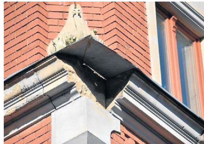
Miejsce pracy władz miasta jest wpisane do rejestru zabytków i wymaga remontu
