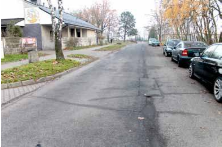
Niezbędne jest utrzymanie dróg w należytym stanie technicznym i funkcjonalnym
