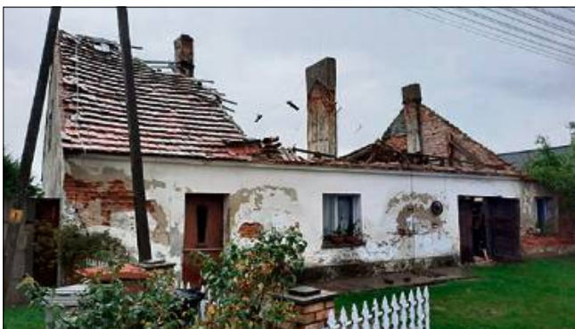
Nawałnica zerwała dach w Straduni.
