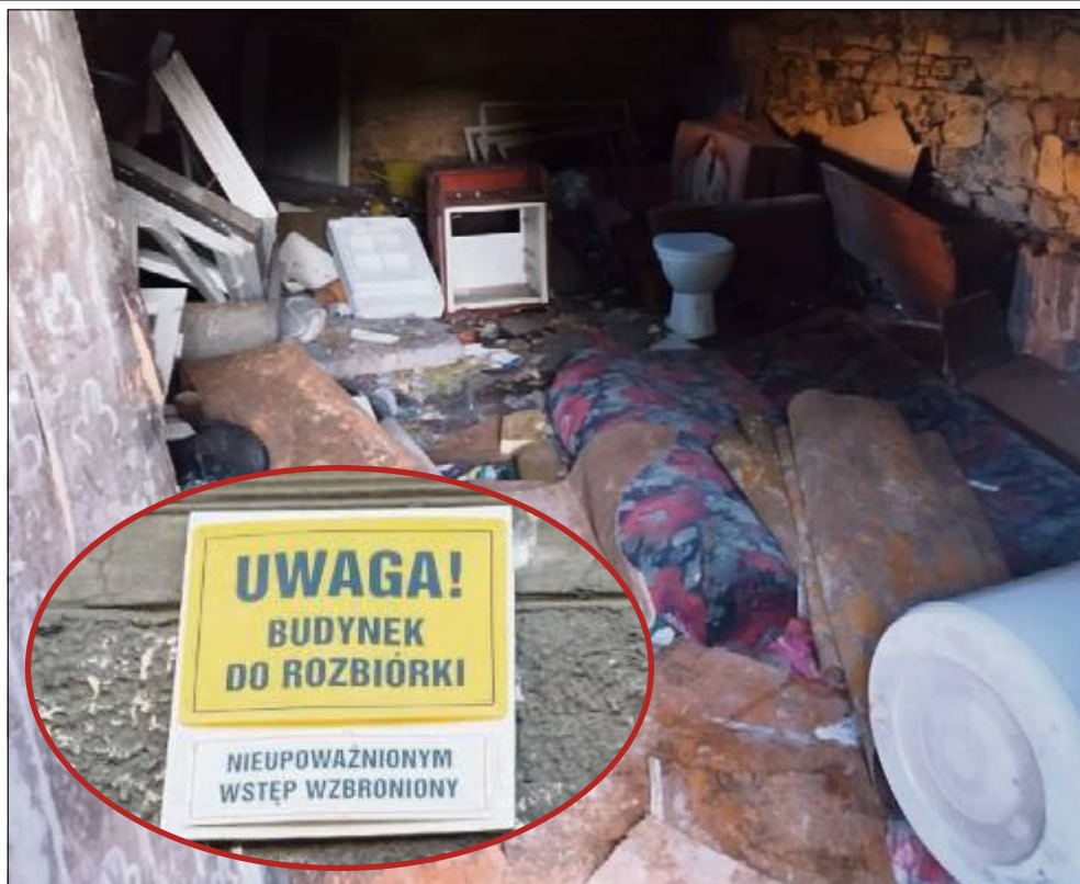
Budynek przeznaczony jest do rozbiórki.
