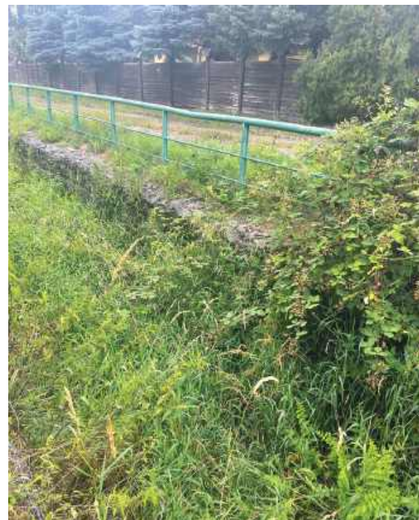
Zarośla przy potoku sięgają już do przydrożnych barier ochronnych
