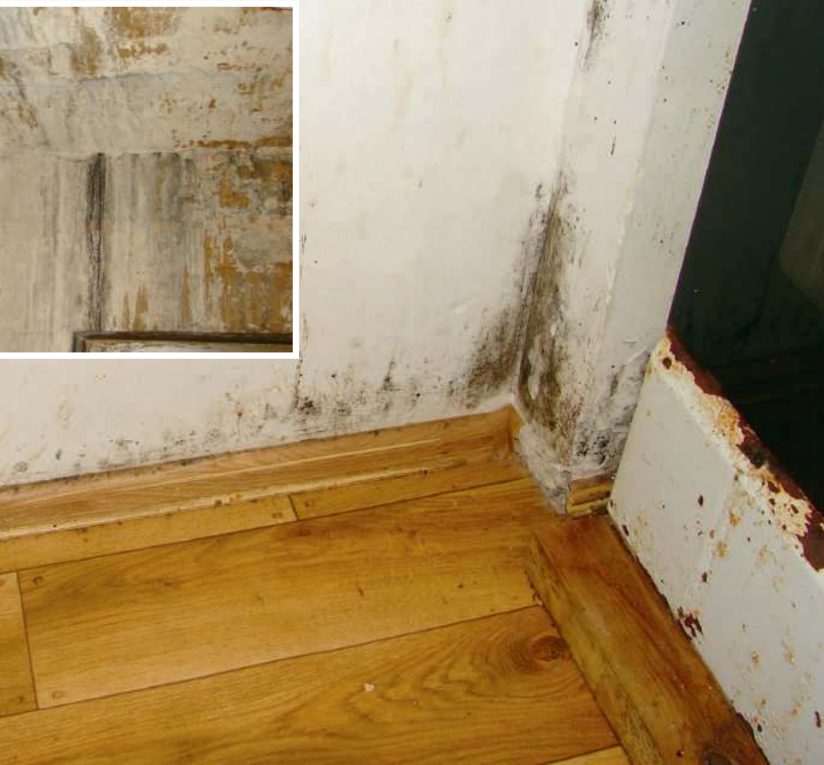
Otwocka 12 – zniszczona ściana pierwszej klatki schodowej w części położonej pod dachem | fot. Janusz Sujecki/Gazeta Polska
