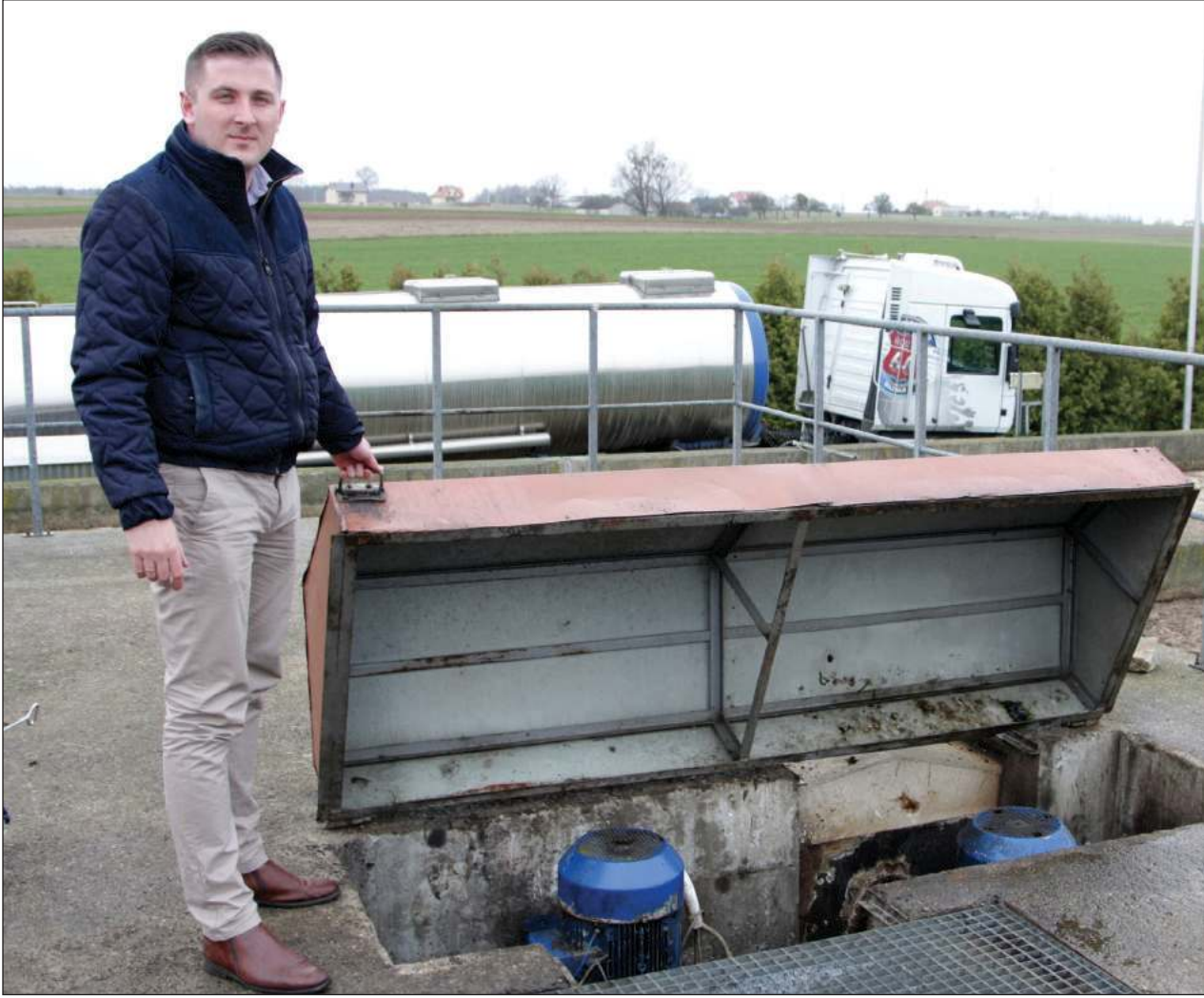
Wójt Maciej Błachnio przy dwóch z czterech rotorów, pracujących jeszcze na oczyszczalni. Między innymi one zostaną wymienione
