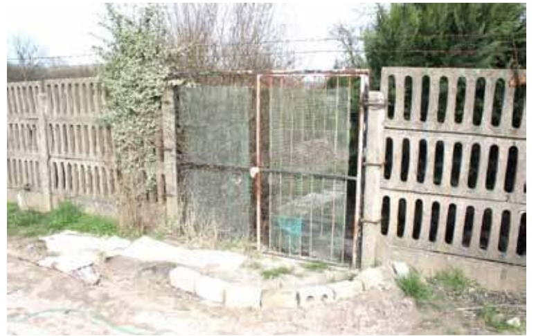
Jak relacjonował spotkany na miejscu mieszkaniec, przy jednym z wejść na działki trzeba było ułożyć cegły, które stanowiły element zabezpieczający przed wdzierającą się wodą
