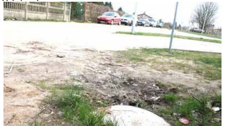
Z widocznej na zdjęciu studzienki woda opadowa wylała się i zalała teren ROD na ul. Orzeszkowej przy obwodnicy północnej
