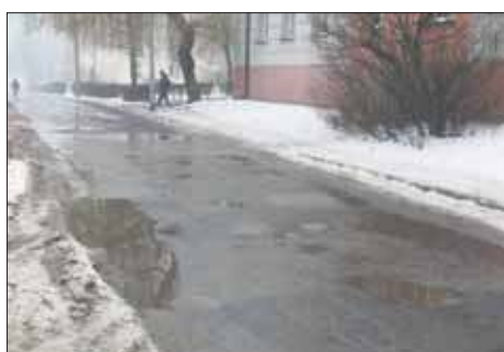
Zniszczona nawierzchnia ul. Tuwima
