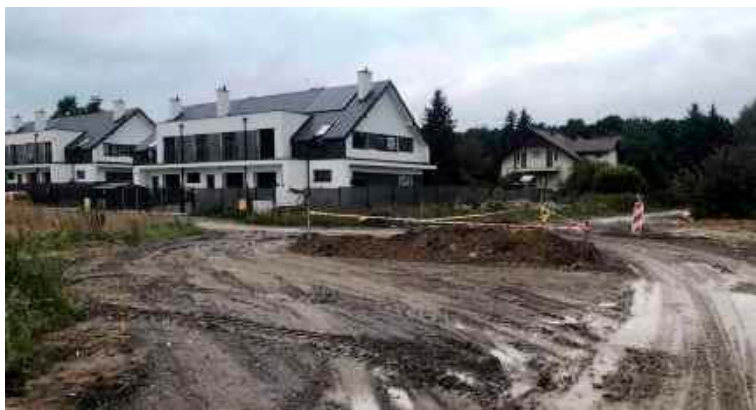
Po deszczu jedyny dojazd do domów przy budowanym odcinku ulicy zamienia się w błotnistą breję
