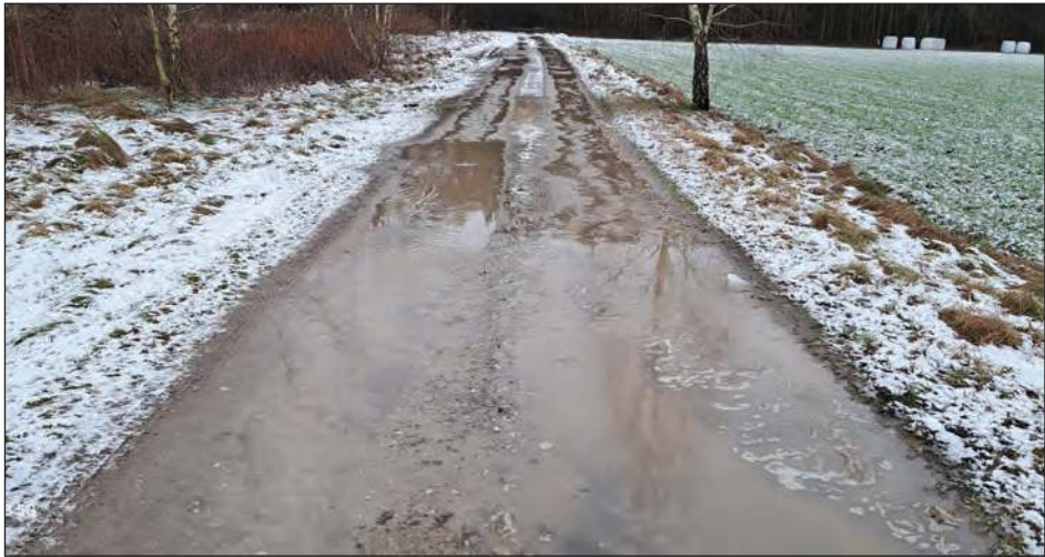
■ Po opadach deszczu, z powodu braku rowów i przepustu, woda płynie drogą. Zdjęcie z początku lutego tego roku
