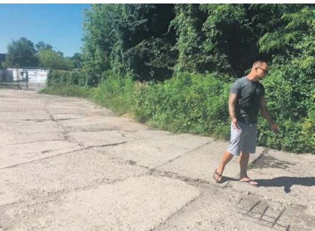
Z betonowych płyt na dawnej fablokowskiej drodze wystają metalowe pręty. Jazda tą trasą to wyzwanie dla zawieszenia samochodu
