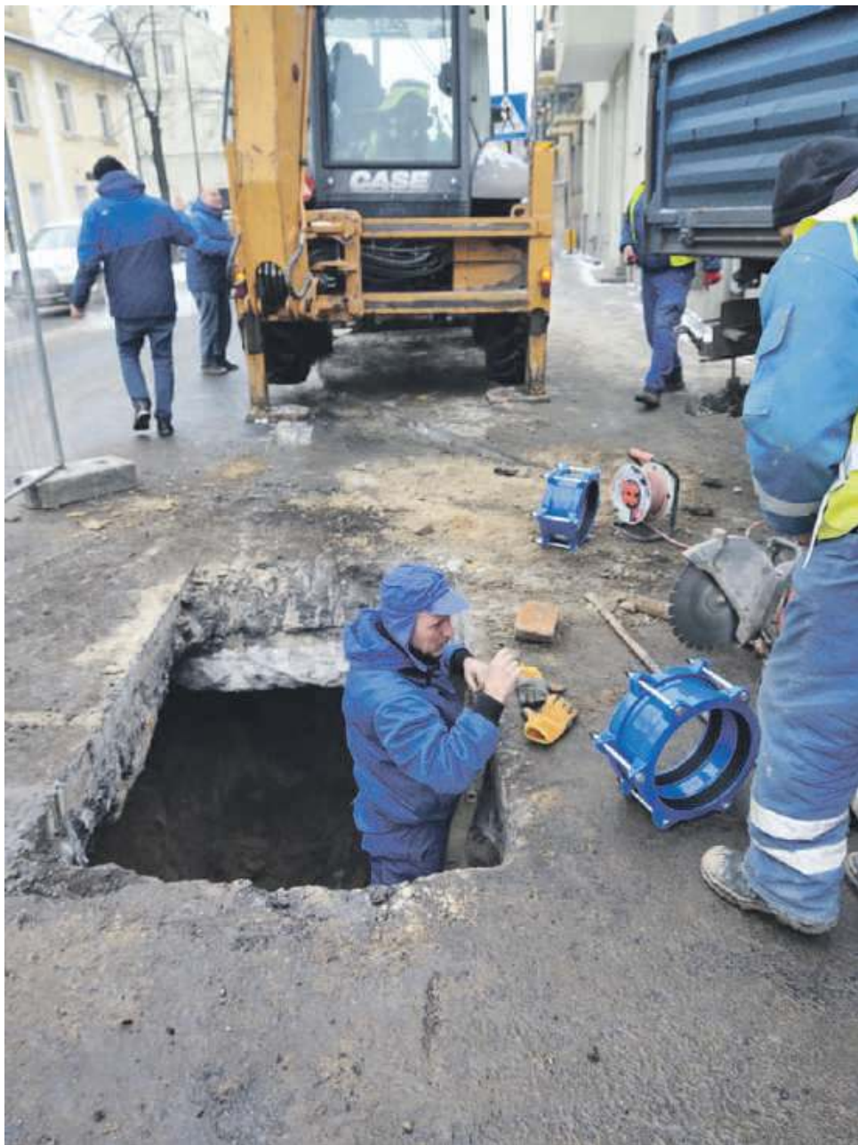
Zniszczony fragment wodociągu trzeba było odciąć i wstawić nowy kawałek, co nie było łatwe, bo - jak powiedzieli nam pracownicy ZWiK - rura jest nietypowa
