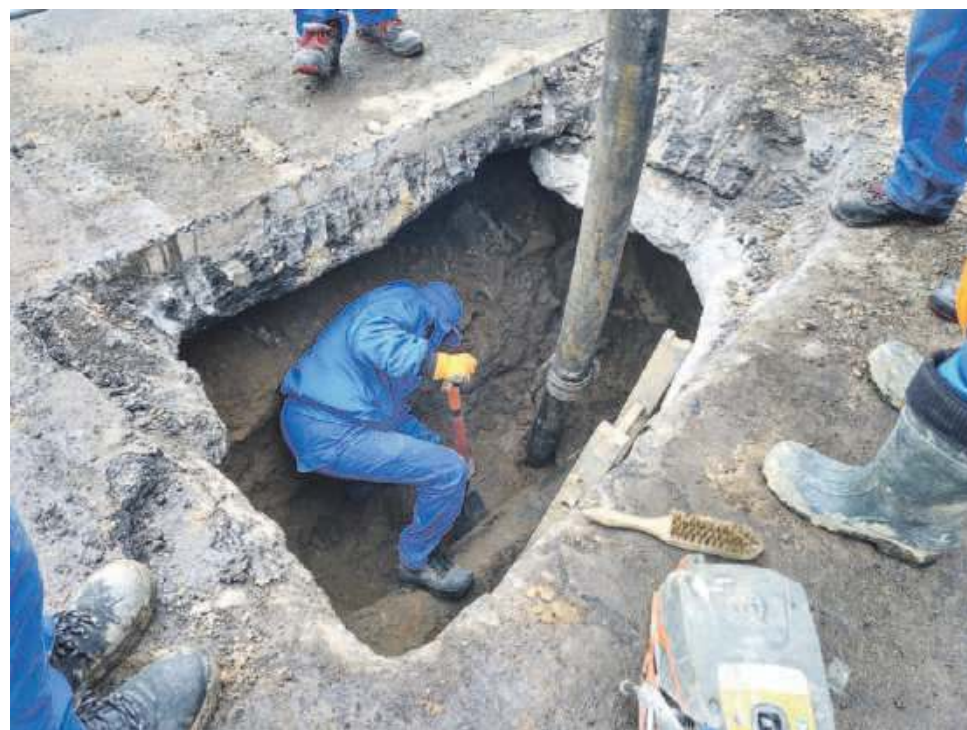
Po odnalezieniu miejsca awarii i odkopaniu rury okazało się, że jest pęknięta
